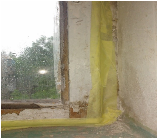
Рис. Г.9. Неущільнені вікна
