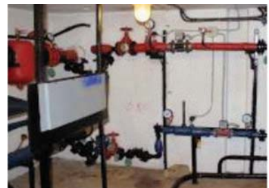
Рисунок 1.13 Інженерні комунікації та обладнання
