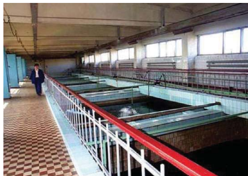
Рисунок 5.5 Водопровідні очисні споруди
