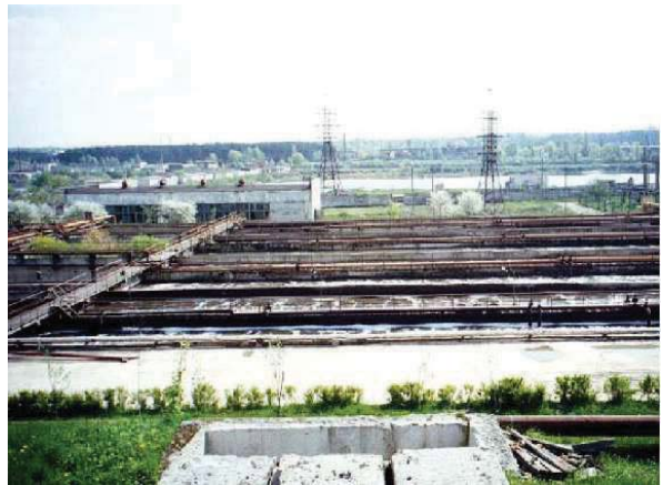
Рисунок 5.9 Каналізаційні очисні споруди
